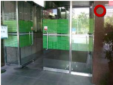
門扇若為整片透明玻璃應設置告知標示，以免視障者或弱視者撞擊。
